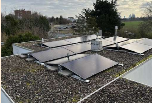
Konfiguration der PV-Anlage auf dem Flachdach.
